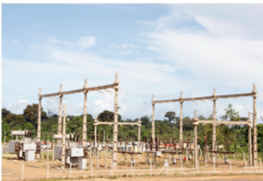
▲ Subestação de Energia Complexo Industrial SINOBRAS
