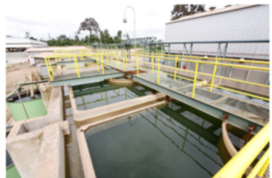
▲ Estação de Tratamento de água
